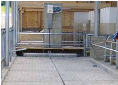
Sicherheits-Abgrenzungen am Koteinwurf-Schacht. Bei der Sicherheit keine Kompromisse!
